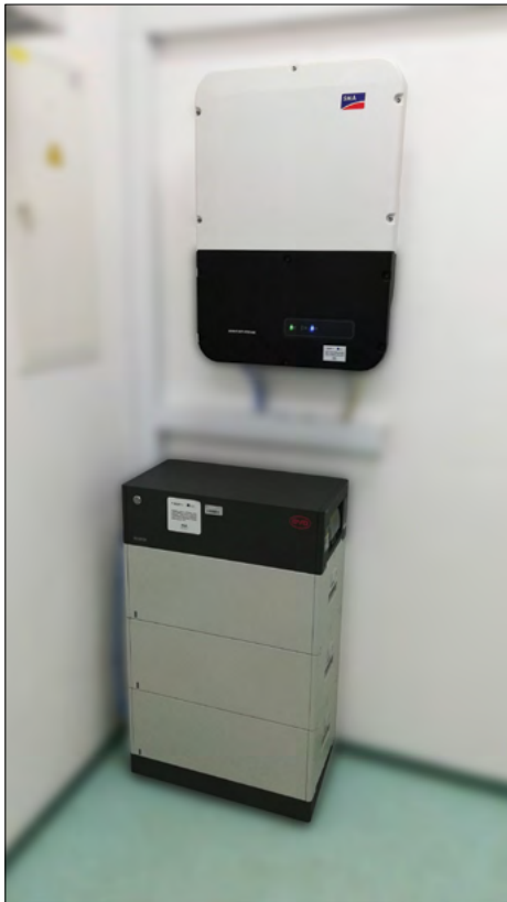
Baterijski modul in hranilnik toplotne energije
