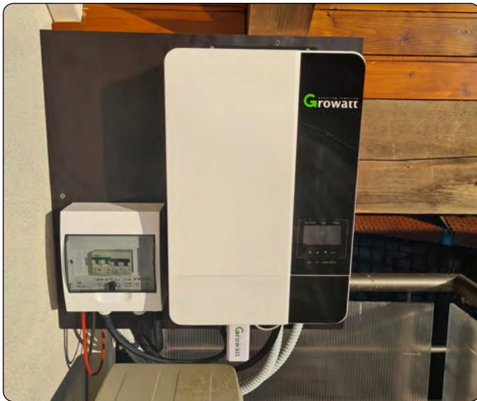
Montiran razsmernik in omarica z DC odklopnikom ter varovalkama. Vir: avtor
