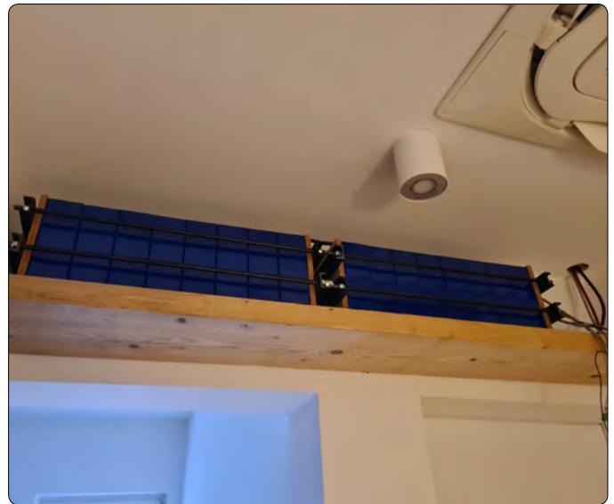
16 celic EVE280K s pripadajočo elektroniko nad preklado. Vir: avtor
